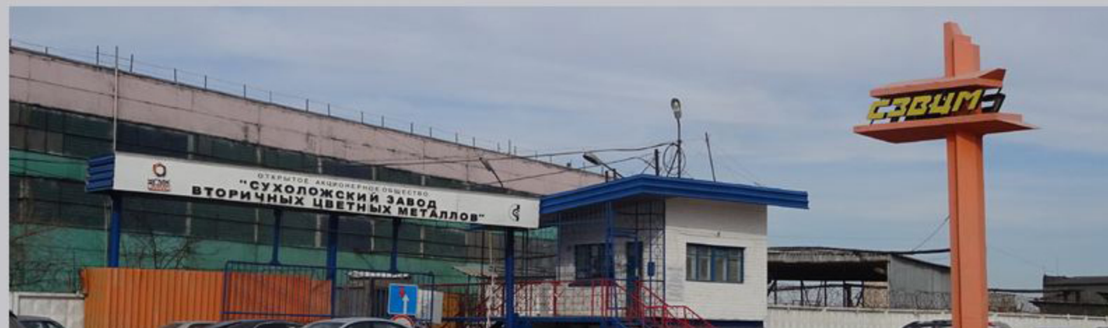
РЕМОНТ И УСИЛЕНИЕ ПЛИТ ПОКРЫТИЯ 5-6 ПРОЛЕТОВ НА ВЫСОТЕ 14-24 МЕТРОВ. АО "СУХОЛОЖСКОЕ ЛИТЬЕ" (ОАО «УГМК»)
